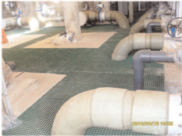
Usine de dessalement (Caillebotis)
