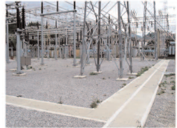
Distribution d'électricité (Caillebotis)
