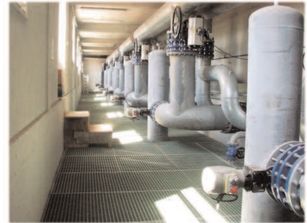
Traitement des eaux (Caillebotis)
