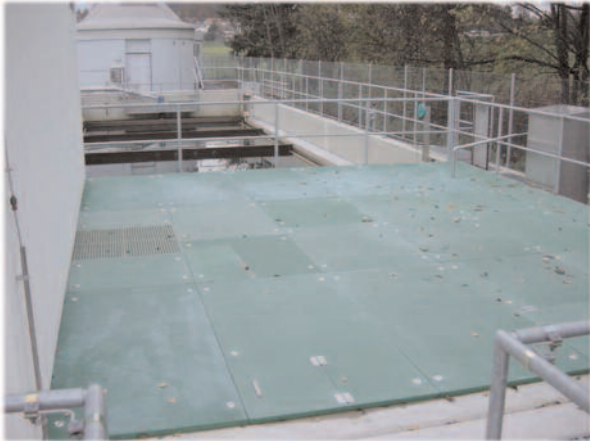
Traitement des eaux (Caillebotis surface pleine)
