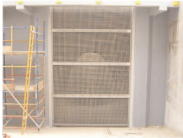
Station pompage eau de mer (Caillebotis et profilés)
