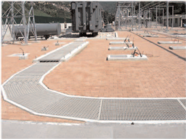
Distribution d'électricité (Caillebotis)
