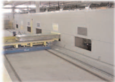
Chambre de polymérisation
